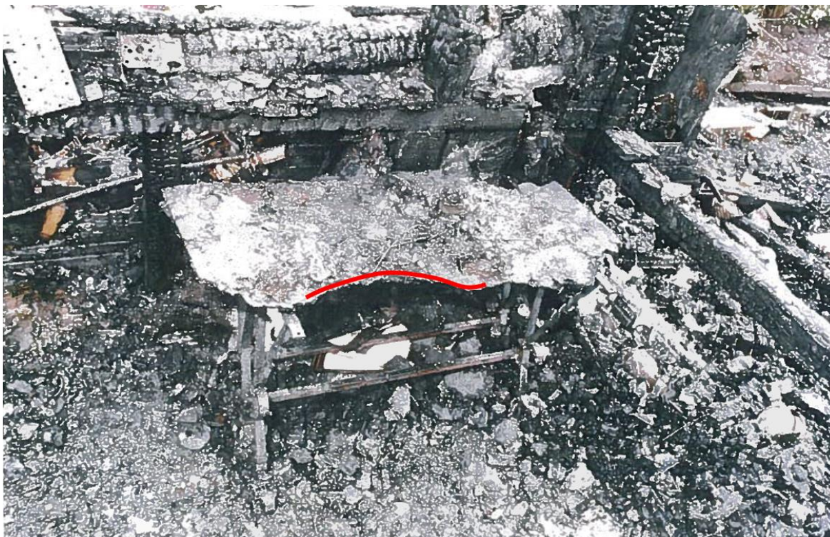
Abbildung 4 Halbkreisförmige Einbrandspur an der Tischplatte am Kopfende des Sofas [Foto: LKA, Bild 49]
